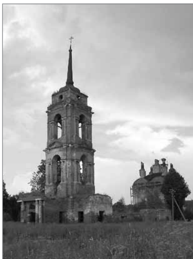
Ил. 18. Колокольня со Скорбященской церковью, конец 1810-х – начало 1820-х гг. На заднем плане – церковь Успения, 1729–1736. Село Дольское Малоярославецкого района. Фото Е.А. Шорбан. 2010
